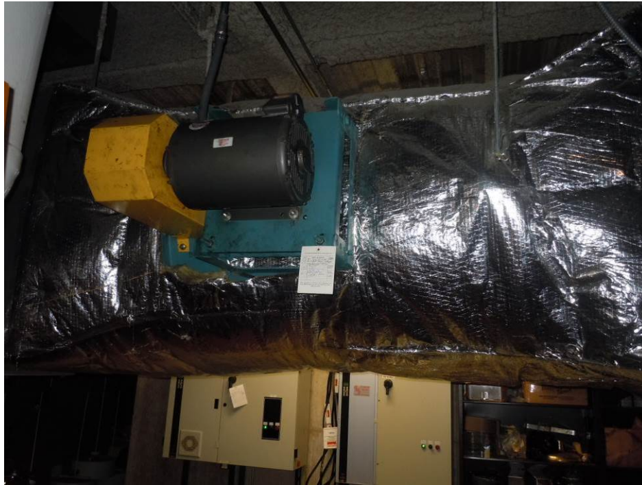
12. 1997 Air System Exhaust Return Fan ER-2
