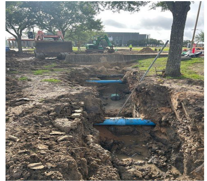
Underground utilities in COMmons
