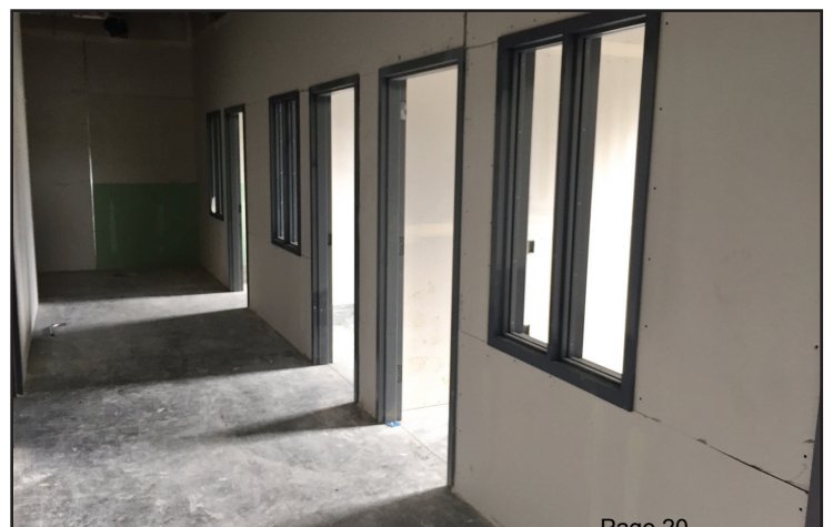
Main office door frames
