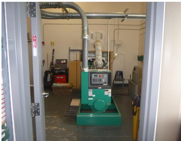
Photo E2 – Generator
