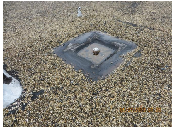
Photo 17: Vestibule Drain / Conduit Area
