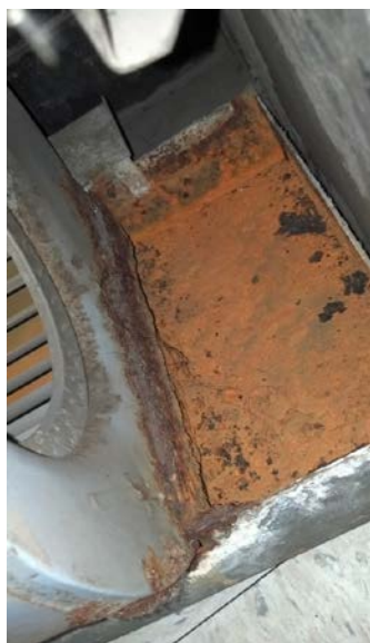
Rusted Unit Ventilator Fan Assembly
